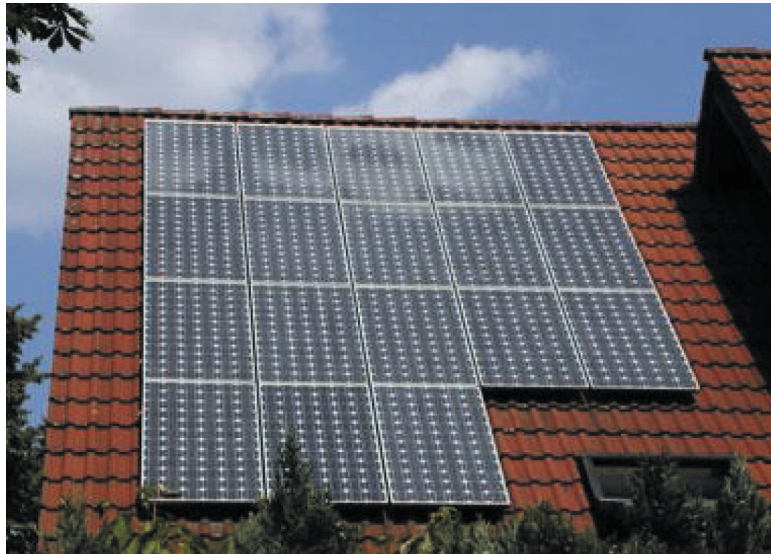
Рисунок 10.2. Солнечные батареи на крыше дома
